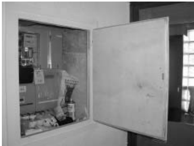
Sicherungskasten mit asbesthaltiger Brandschutzplatte an der Innenseite der Tür, Foto IST
