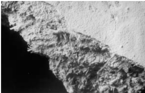
Zerbrochene Asbestzementplatte mit sichtbaren Asbestfaserbüscheln, Foto: SA
