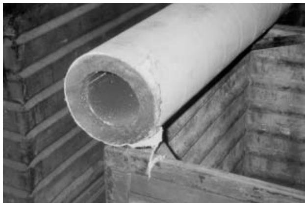
Asbesthaltige Rohrisolation, Foto IST
