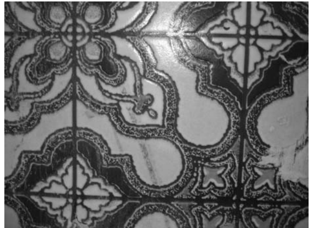
Dreischichtiger Bodenbelag mit Asbestpappe, Foto: Carbotech AG
