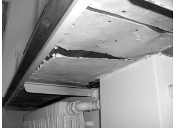
Frei zugängliche Asbestpappe an Fensterbrettuntersichten, Foto: Kant. Lab. Basel-Stadt
