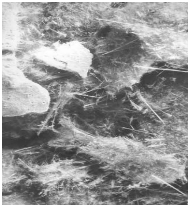
Vergrößerung eines Spritzasbestbelags mit Fasern aus Mineralwolle und spitzen Asbestfaserbüscheln, Foto: SA
